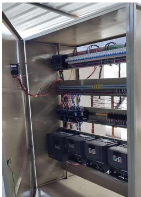
Ilustración 7. Panel de control eléctrico.
